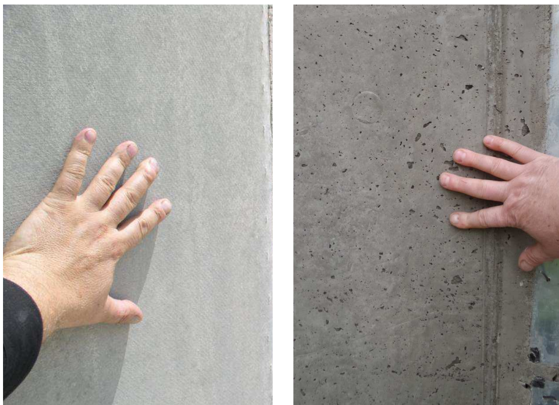
Obr. 1. Porovnání povrchů betonových stěn nádrží
